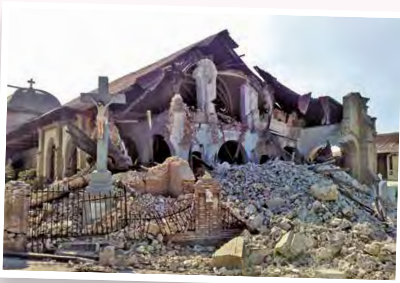
A Igreja Sacré Coeur de Tugeau, em Porto Príncipe, em ruínas após o terremoto.
